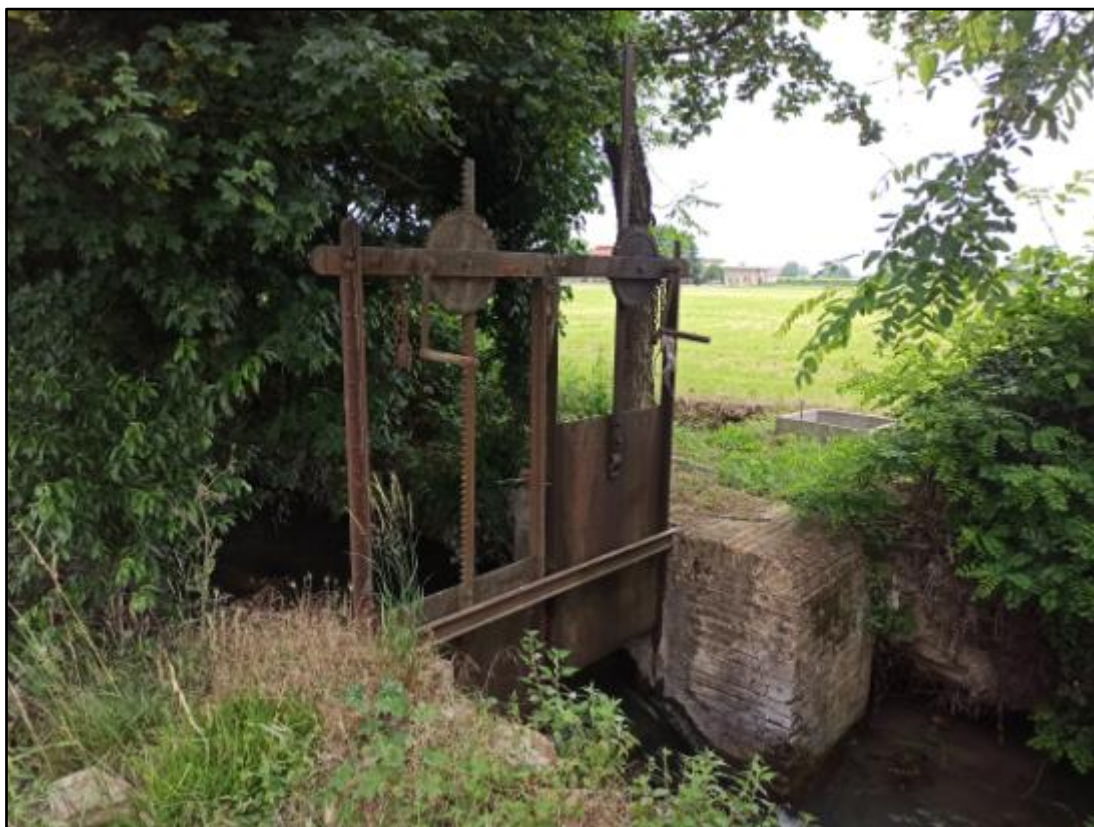
Figura 63: Chiavica secolare con grande paratoia lungo la Canalina di Bibbiano – particolare.
